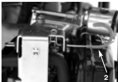
Рис. 6. Запуск генераторного блока
