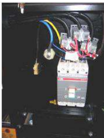
Мал. 1: Відкрита електрична панель
